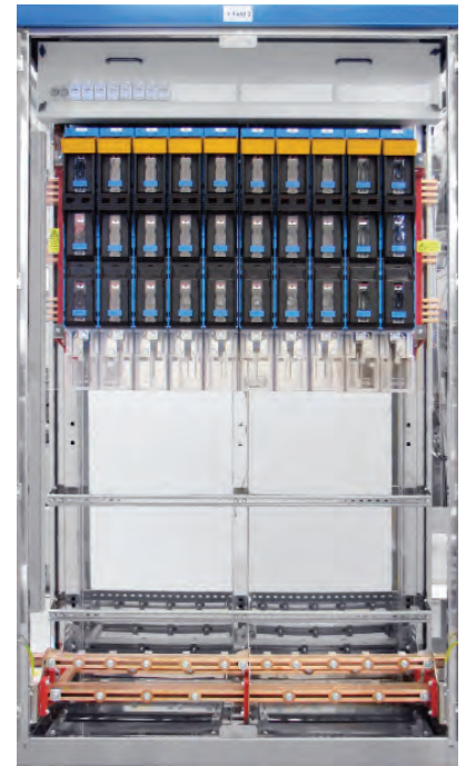
Abgangsfeld mit fest eingebauten NH-Sicherungs-Lastschaltleisten
