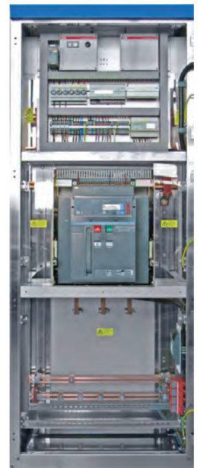
▲ Leistungsschalterfeld mit offenem Leistungsschalter von 630 A bis 6300 A
