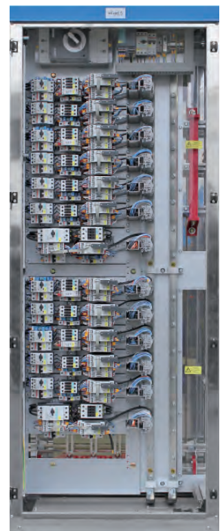
▲ Abgangsfeld mit fest eingebauten Motorabgängen
