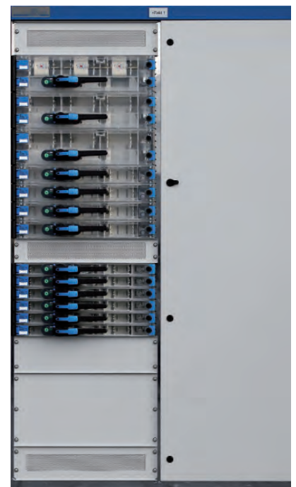
Abgangsfeld mit steckbaren NH-Schaltersicherungsleisten
