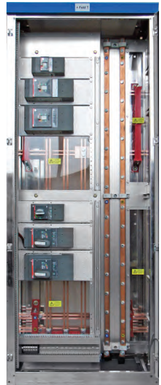
▲ Abgangsfeld mit fest eingebauten Leistungsschalterabgängen
