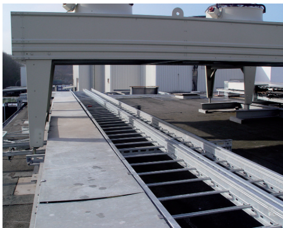
Kabeltrasse in einem Produktionsbetrieb
