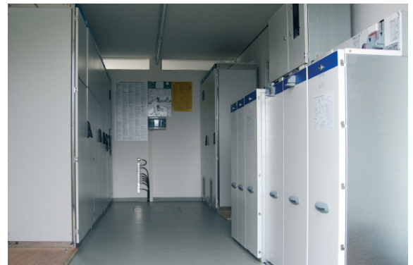
Begehbare Transformatorstation, Innenansicht ▲
